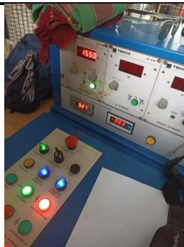
Gambar 8. Hasil pengukuran pada panel control
