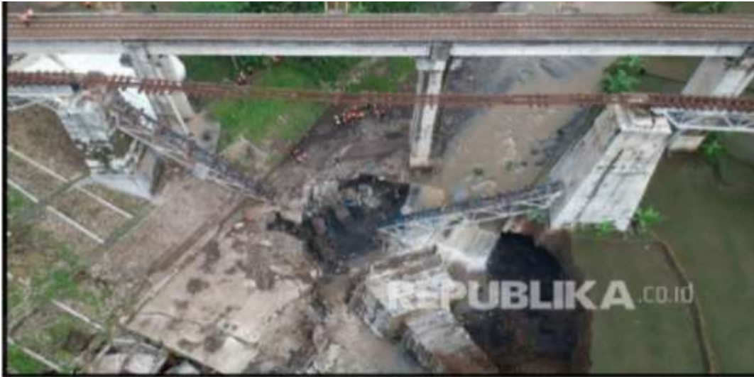
Gambar 1. Jembatan Kereta Api Ambruk di Brebes, Jawa Tengah Sumber: https://www.republika.co.id/
