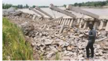
(c) Pasca konstruksi (kegagalan)
