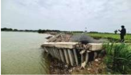
(b) Pasca konstruksi (Kegagalan)
